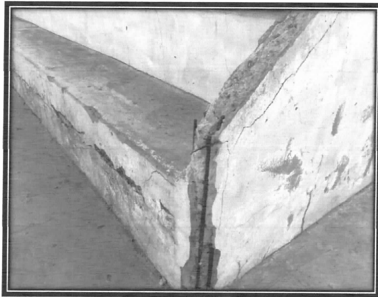
IMAGEM 04 – SITUAÇÃO DA ARQUIBANCADA
