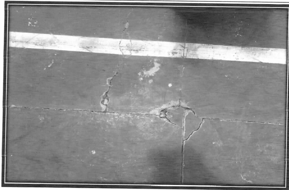
IMAGEM 05 – SITUAÇÃO DO PISO DA QUADRA
