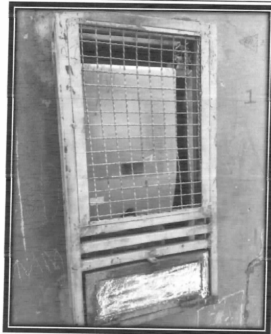
IMAGEM 09 – QUADRO DE DISTRIBUICAO DE ENERGIA
