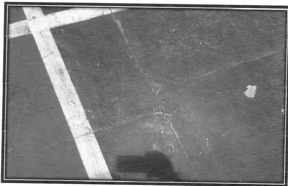
IMAGEM 04 – SITUAÇÃO DO PISO DA QUADRA
